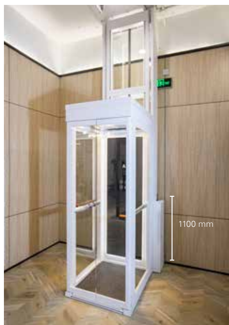
Exemple d'ascenseur privatif avec le compartiment électrique installé sur le mât à l'étage inférieur.
